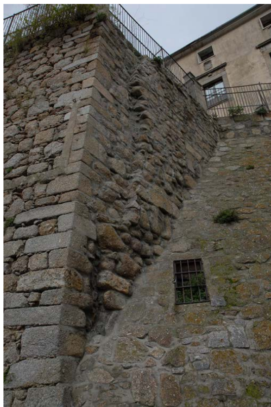
Tramo C5, detalle esquina con rotura de fábrica
