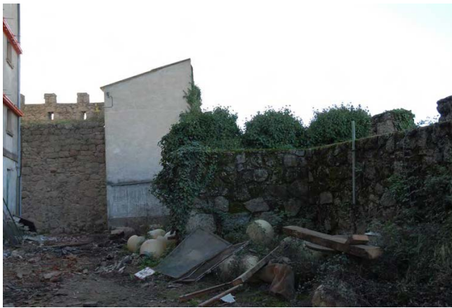
Tramo 40, intramuros, arranque con transformador superpuesto
