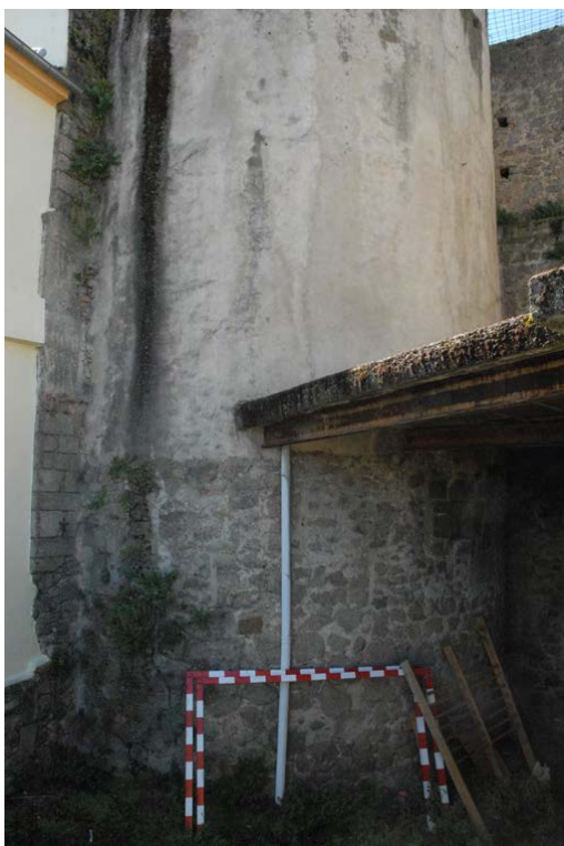
Tramos recinto exterior del castillo, lado oeste torreón parcialmente recrecido
