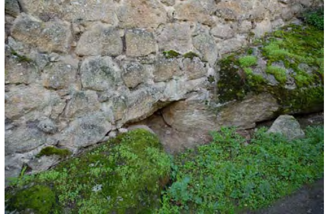
Tramo 16, intramuros, zona intermedia, detalle coquera en arranque
