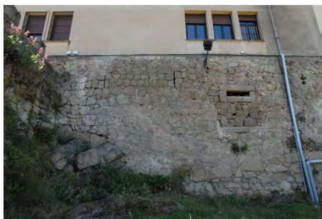
Tramos recinto exterior del castillo, lado norte, encuentro con lienzo del Huerto del Aire, saeteras y antiguos huecos.
